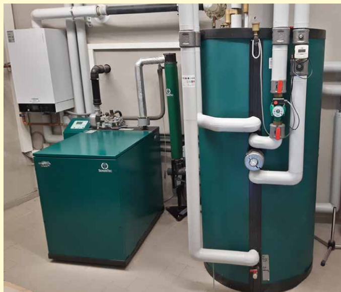
Familie Camerer kann mit dem installierten Dachs 100 Prozent ihres jährlichen Wärme- und 90 Prozent ihres Strombedarfs decken.
