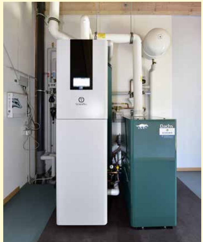
Der Dachs InnoGen deckt bei den Dilgers den kompletten Wärmebedarf sowie die Hälfte des jährlichen Strombedarfs.
